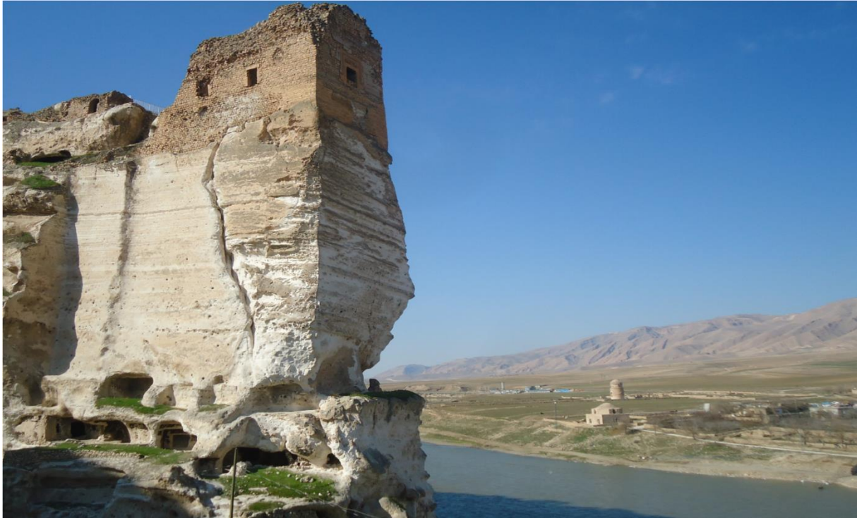
Figure 10 : Petit palais, situé sur l'extrémité Nord-Est de la citadelle. En arrière-plan, de l'autre côté du Tigre, on aperçoit le hammam artukide et le mausolée de Zeynel Bey Auteur, février 2015 Le petit palais est menacé d'effondrement, car la montée des eaux va fragiliser la roche
